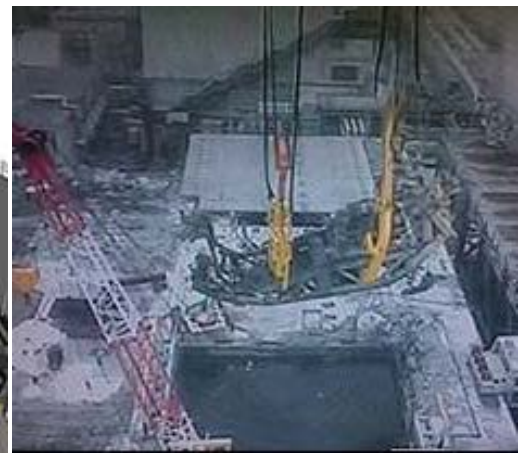
図10 燃料交換機吊上げ写真
