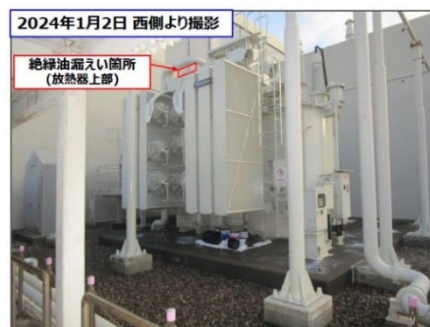
1号機 起動変圧器の損傷
