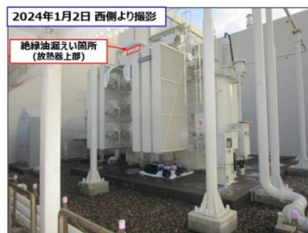
1号機 起動変圧器の損傷
