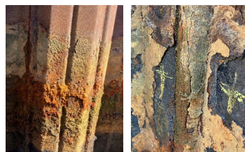
図3 軽量鋼矢板の腐食状態 (暴露期間5年 普通鋼)
