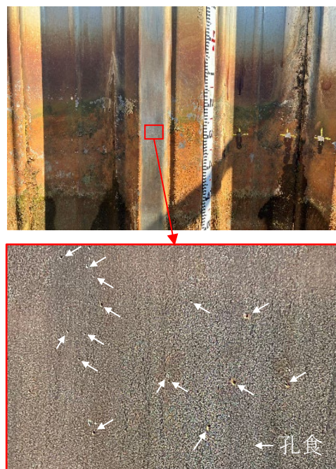
図 4 ステンレス鋼矢板の孔食発生状態 (暴露期間 5 年 SUS430)
