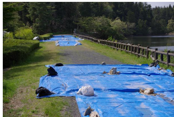
図 1 被災したため池
