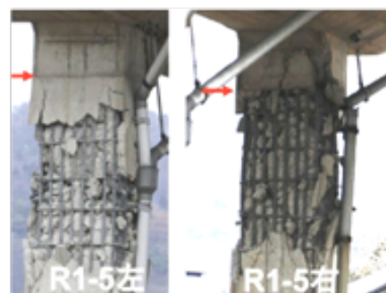
第1中曽根橋（矢印は打継目） 図3 R1橋の第5柱の損傷状況
