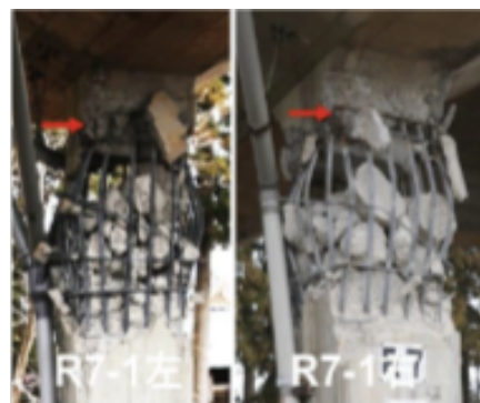
第1中曽根橋（矢印は打継目） 図2 R7橋の第1柱頭部の破壊状況
