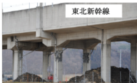
R6 橋-橋脚頭部は斜亀裂、脚頭部が破壊-R7 橋 図1 第1中曽根橋のR7橋-端橋脚とR6橋-老番側（東日本太平洋沖地震,2011）
