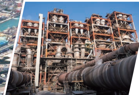
上から、リクレーマ(石炭の払出設備)、低温炭化によりバイオマスの取扱いを容易にしたトレファイドペレット、廃プラスチック処理設備、九州工場苅田第一地区キルン
