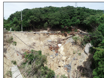
道路災害調査(伊方町)
